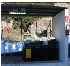
Extintors al Punt Net
